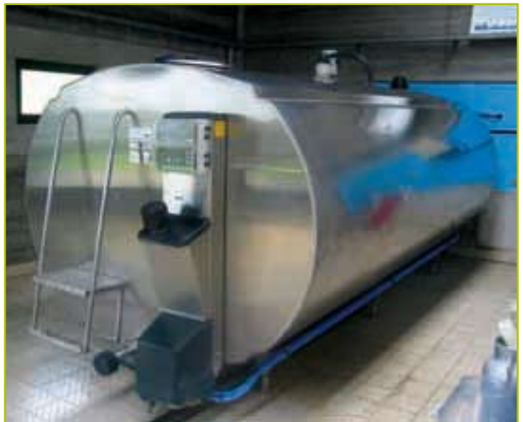
Photo 4 : La ventilation de la laiterie est essentielle pour limiter les consommations du tank
