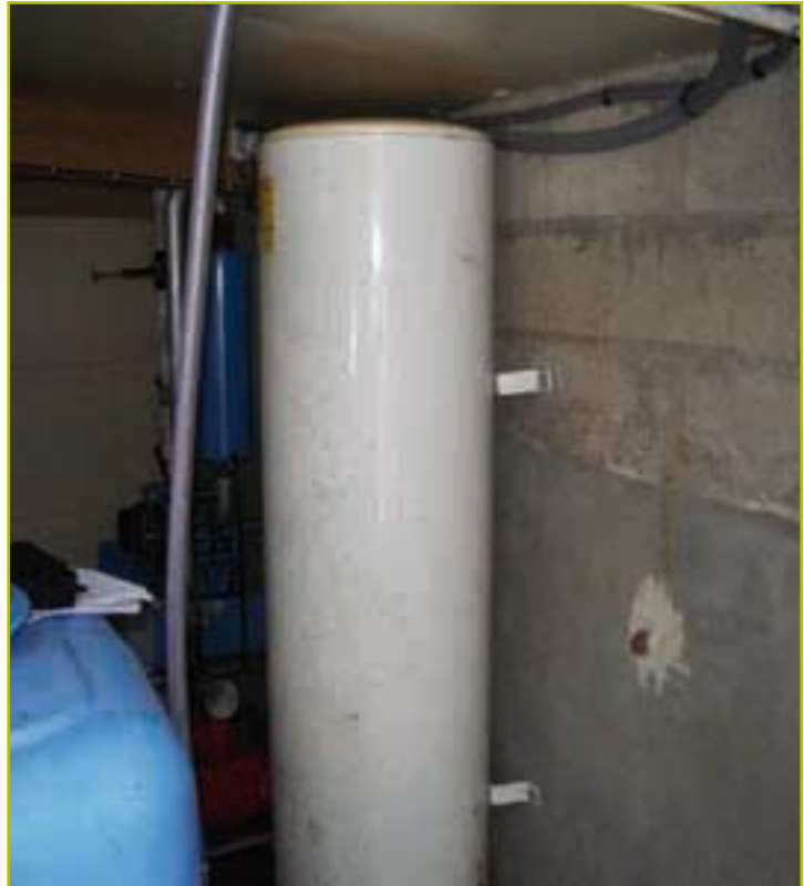
Photo 5 : Un chauffe-eau âgé de 10 ans peut consommer 30 % d'électricité en plus
